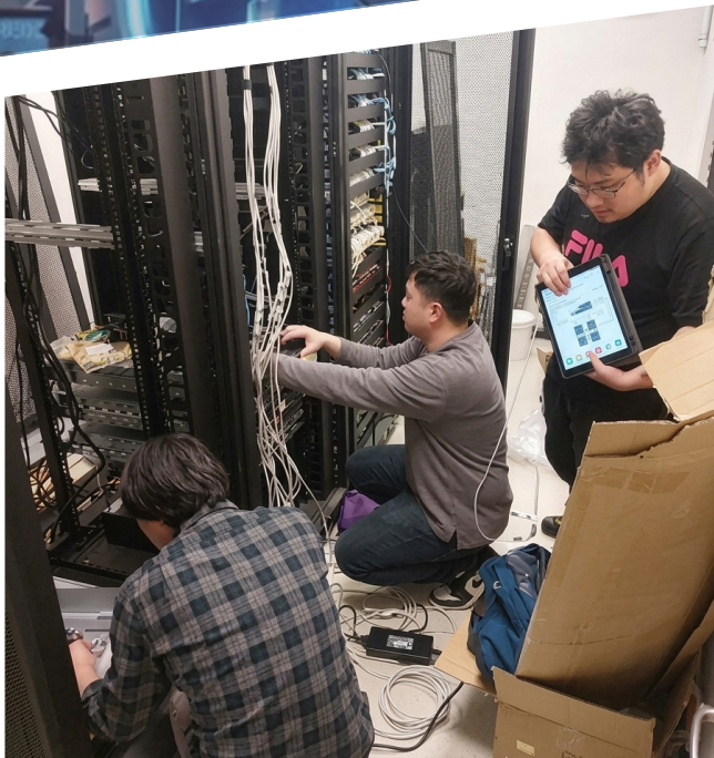
12 小時的極速移地，包含拆除、運送、安裝、測試的環節，確保查驗通關服務零中斷
