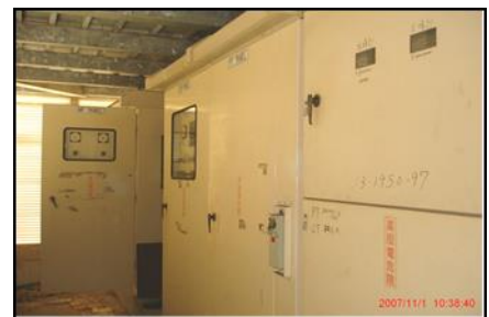
緊急發電機設備
